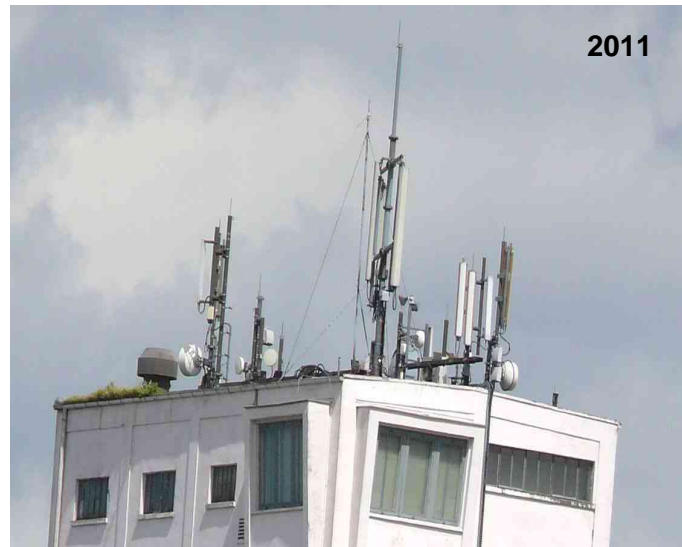
Mobilfunksendeanlage D, Nr. 671024, Lagerhausstr. 19 (Höhe 47 – 54 m, 12 Sektorantennen im Jahr 2011, 15 Antennen ab 2014)
