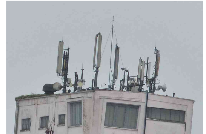
Sendeanlage D (Höhe 47-54 m)
